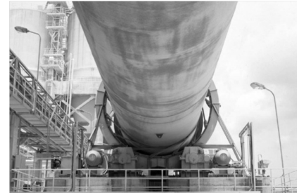
Piec obrotowy cementu
